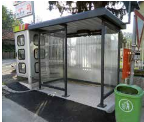
Buswartehäuschen Wagnergasse mit frontseitiger Glasplatte als Schutz gegen Schlagregen
